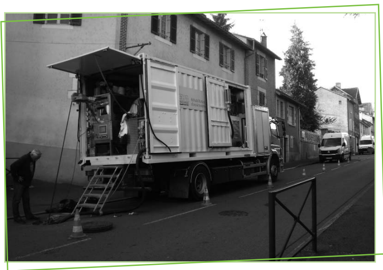
Poste de commande des travaux de chemisage... à la pointe de la technologie.
